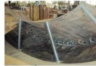
JCL-023(沉箱鐵腳)
